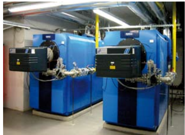
Brennwertkesselanlage mit Erdgasbefeuerung
